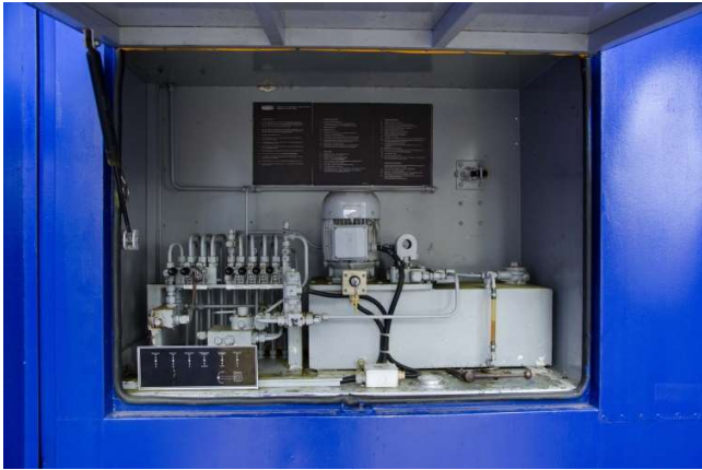
Hydraulikpumpe und Steuerung Seiten- und Dachelemente
