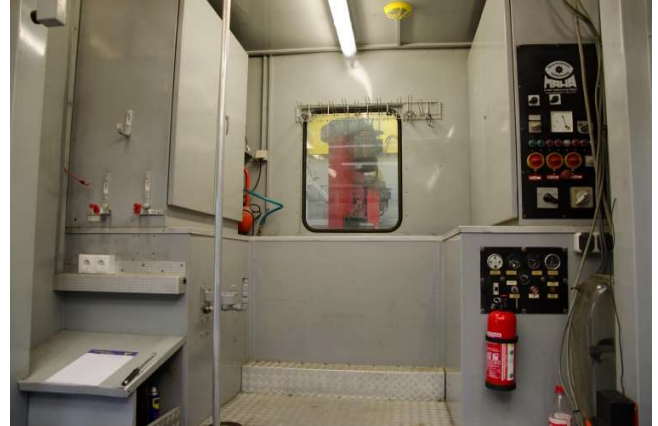
Schaltschränke und Werkzeugfächer+Kompressor
